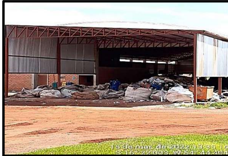
Figura 25 - Usina de Triagem - Depósito de resíduos da Coleta Seletiva
