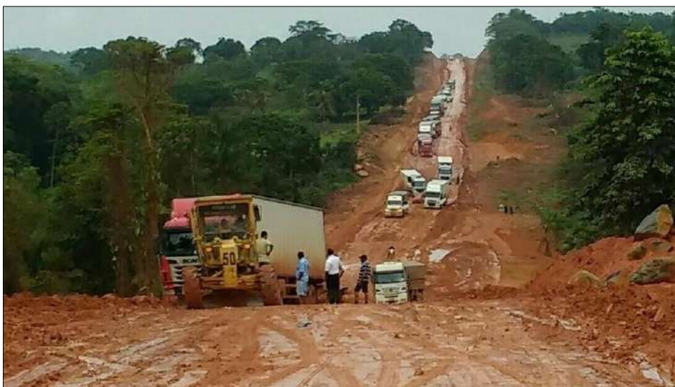
Figura 3- Atoleiro na BR-163 no trecho entre Novo Progresso ao Trairão
