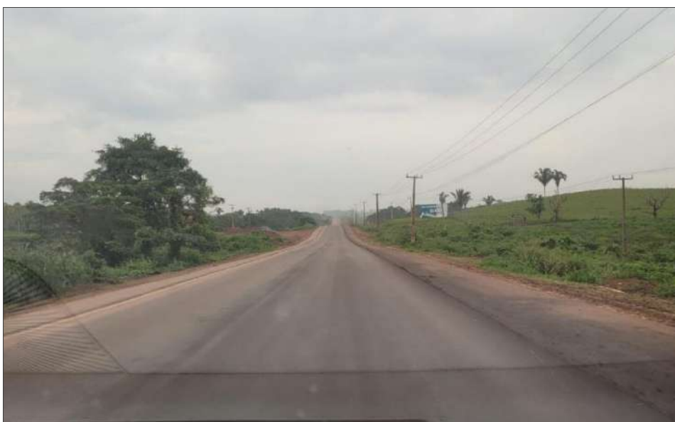
Imagem 42- Asfalto novo sem sinalização
