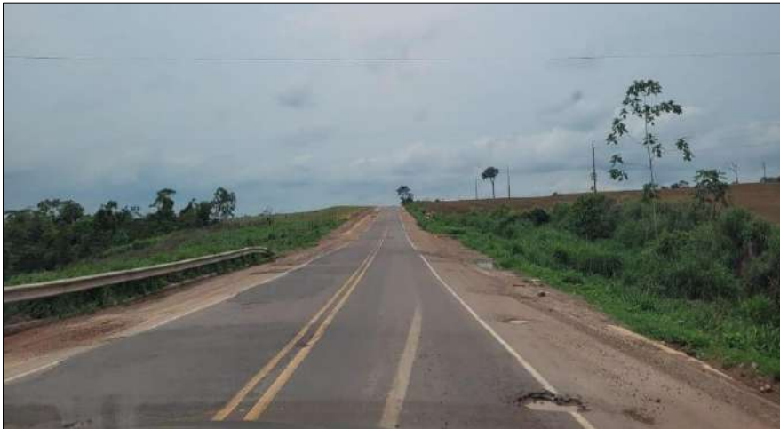
Imagem 26- Asfalto com buracos
