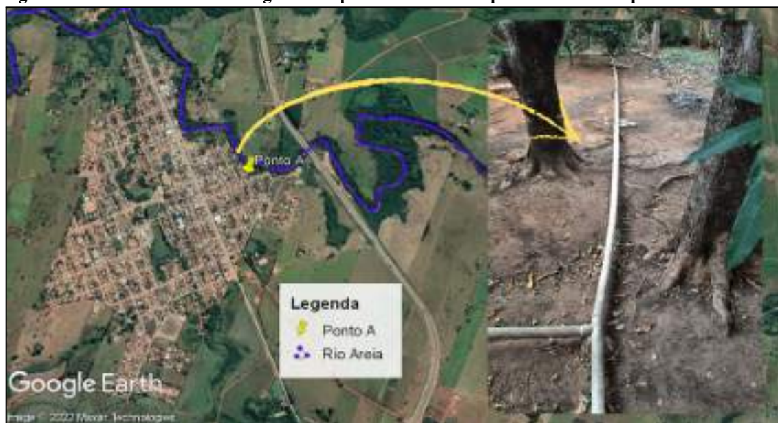
Figura 5.3.4 – Parte da rede de esgoto feita pelos moradores exposta em um dos quintais.
