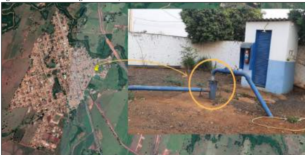
Figura 5.2.1.3 – Saída de água do PT-01, localizado na sede do DAE
