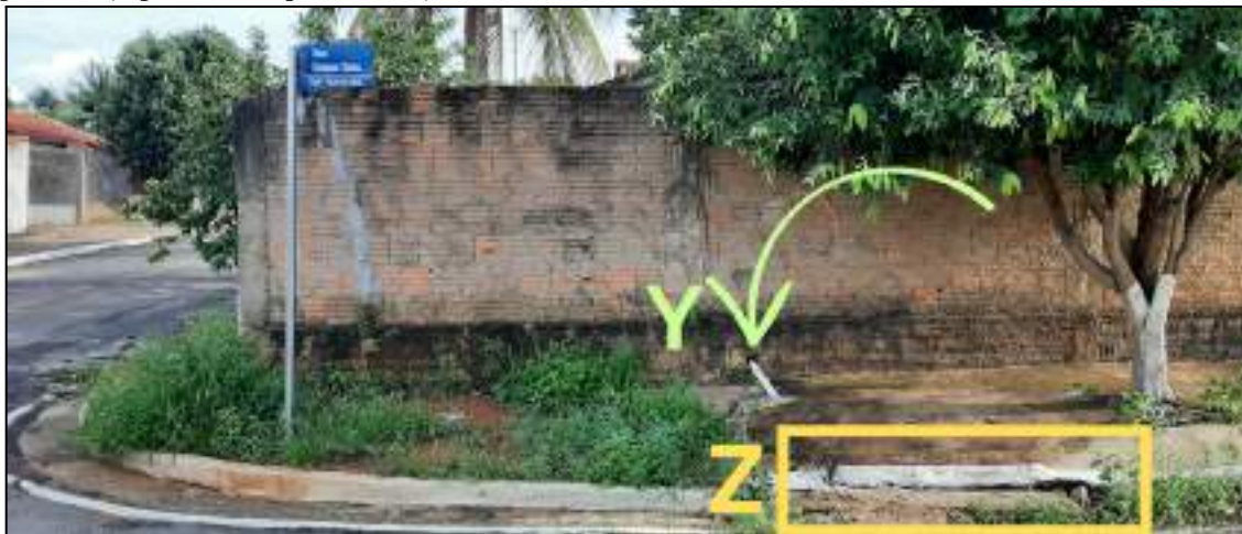
Figura 5.3.1 - Ligação clandestina de esgoto (representada pela letra Y) em galerias de águas pluviais (representada pela letra Z) na cidade de Juscimeira
