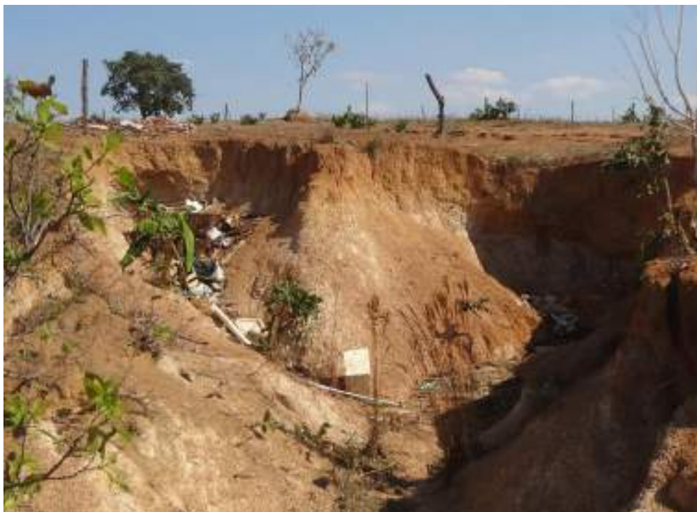
Figura 27 – Processo erosivo com lixo.
