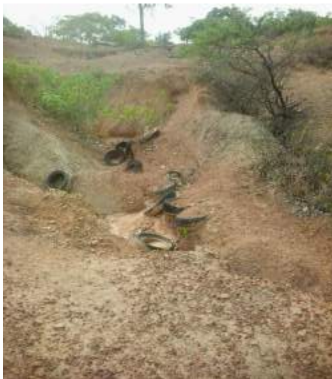
Figura 20 - Barreiras de contenção com pneus, construídas para tentar sanar as erosões.
