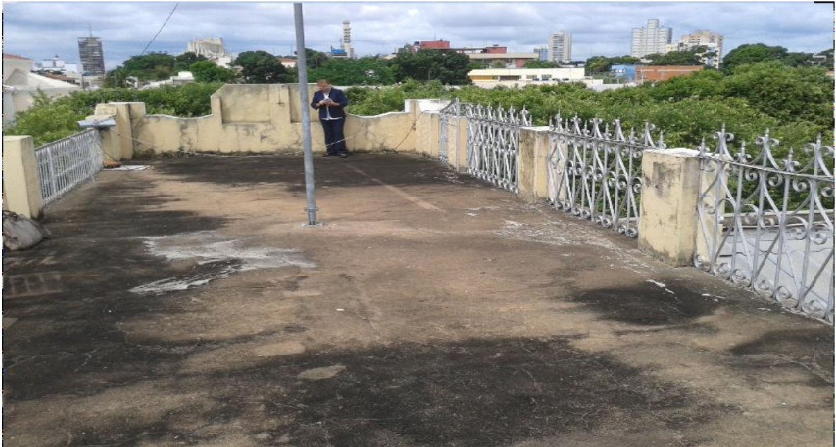
Foto 1: Terraço do Colégio São Gonçalo Cuiabá/MT. Fonte. SILVA, M. P. 2014
