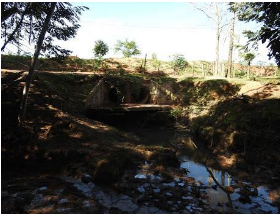
Figura 21- Galeria de água pluvial caindo sobre a nascente.
