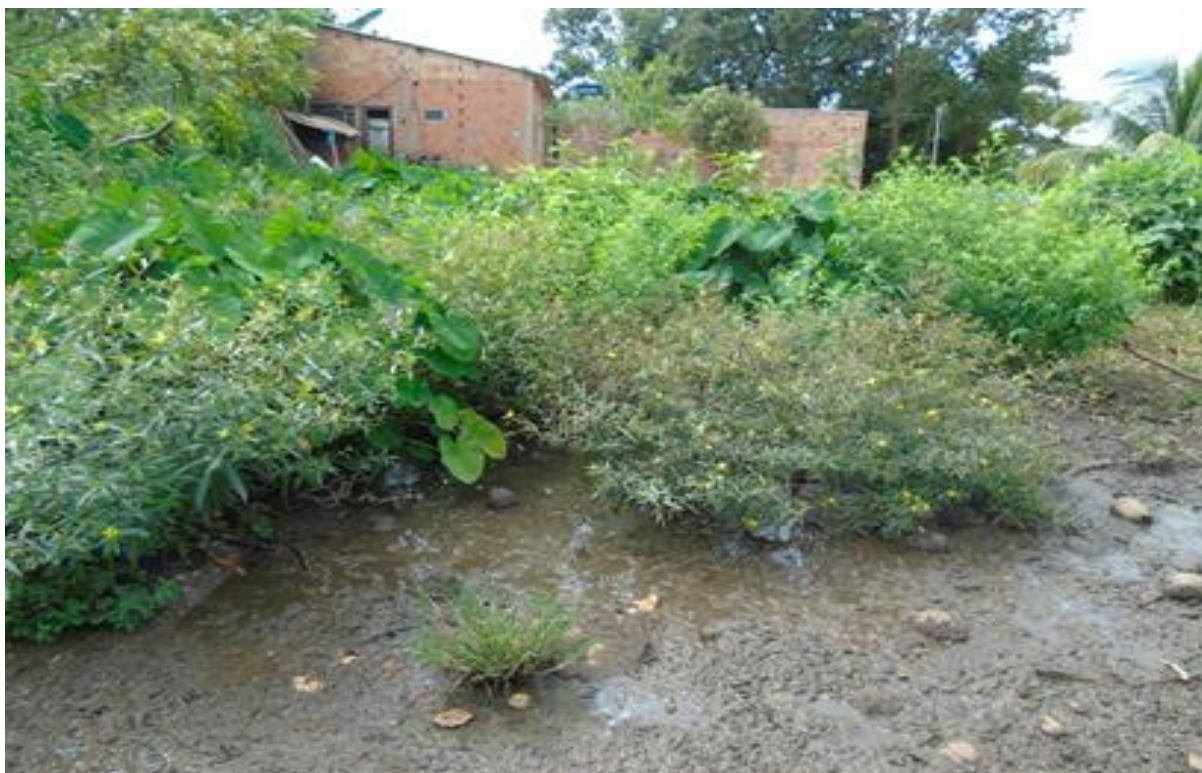
Figura 7- Construção em APP e esgoto correndo a céu aberto, dentro da nascente.
