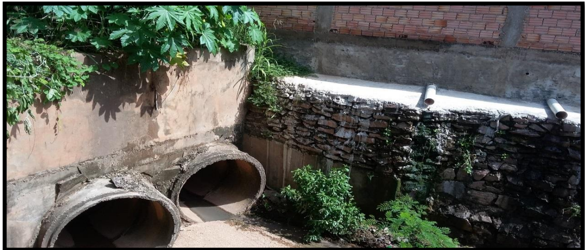
Foto 2 – Esgoto despejado no Córrego Canivete em Rondonópolis-MT.
