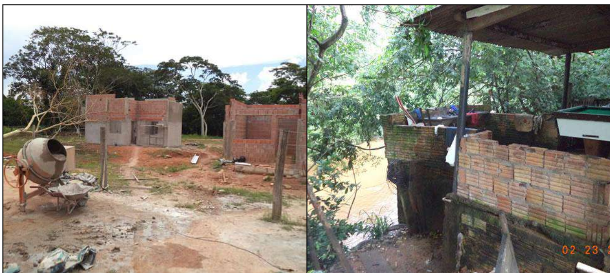
Figura 5.3 Edificações embargadas pela SEMMA, ainda em fase de construção na APP do Rio Vermelho, no loteamento Boa Esperança, à esquerda. Edificação irregular instalada em APP, às margens do Ribeirão Arareau, no bairro Vila Cardoso, à direita.
