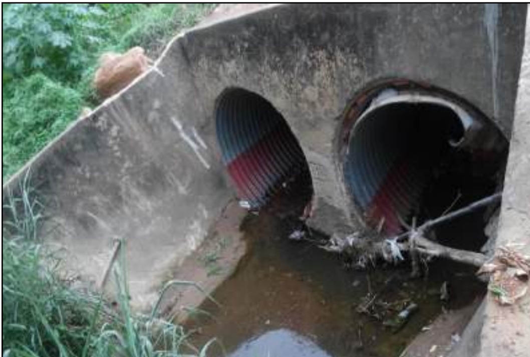
Foto 5.5 - Córrego Canivete – Jd. Assunção II Parte, observamos que o processo de canalização foi iniciado recentemente mas ainda não está concluído.
