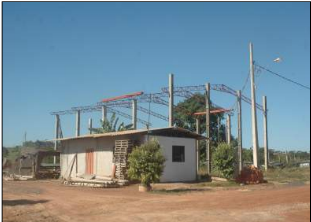
Foto 5.24- Micro Distrito da Vila Operária observamos a construção de galpões e de algumas empresas que serão transferidas para o local. Foto: A. A. P., Maio/2016
