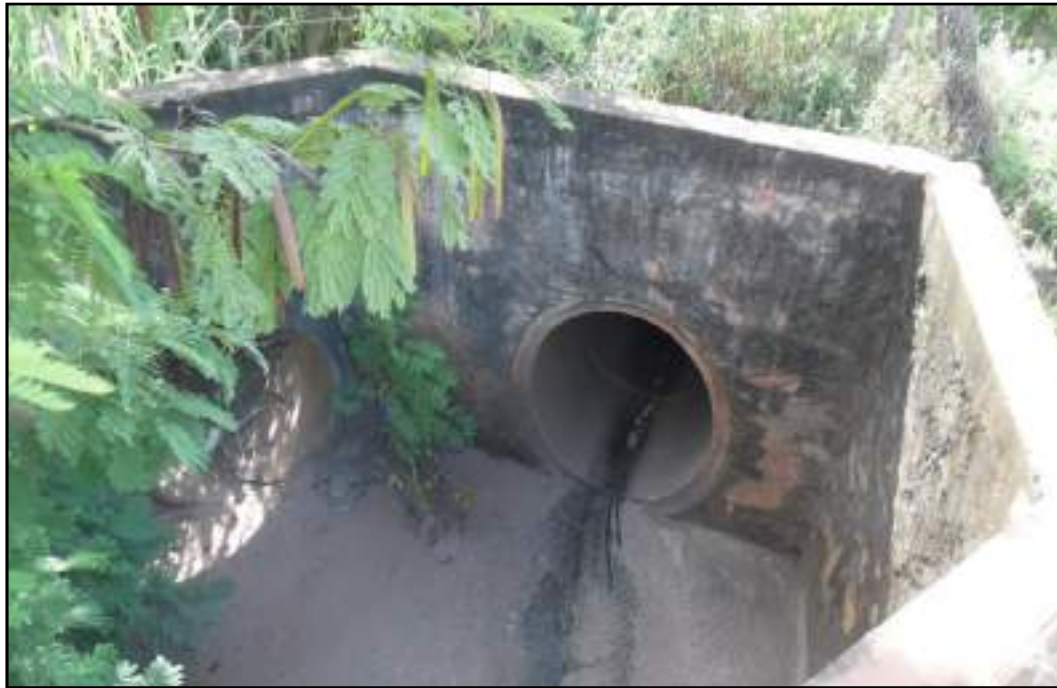
Foto 5.8- Jd. Tropical – Córrego Canivete- a moradora nos relatou que em um primeiro momento, durante o processo de canalização naquele local, foram construídas manilhas baixas e direcionadas às construções e que durante a primeira chuva aconteceu a derrubada da contenção o que ocasionou inundações e até um acidente onde uma moto caiu no córrego neste ponto.
