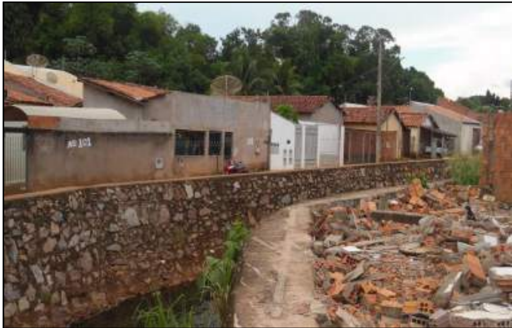
Foto 5.16- Córrego Bambu – pode-se observar que o processo de canalização ainda não foi concluído e também visualizamos a proximidade das construções, com vias de acesso que transita somente um veículo por vez. Foto: A. A. P. Maio/2016
