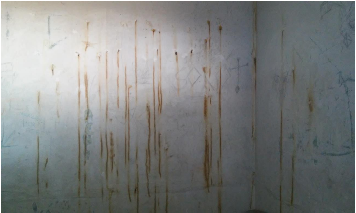
FIGURA 1 – Parede externa da cela com marcas de ferrugem. Fonte: arquivo pessoal do autor.
